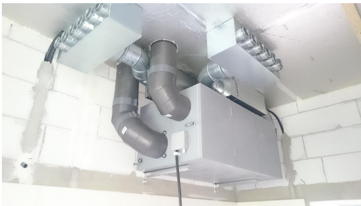
2. ábra Szellőztető gép a mennyezetre szerelve, EPP beszívó/kidobó ággal. A „házfelőli” oldalon 1-1 db hangcsillapító, vízszintesen a gép felett, majd 1-1 db befúvó és elszívó osztódoboz.
